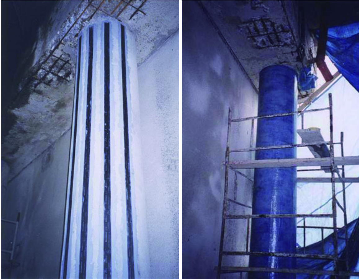
Fot. 2. Wzmocnienie taśmami i matami CFRP słupa filara wiaduktu w Rzeszowie: wzmocnienie taśmami (po lewej), wzmocnienie matami (po prawej)
