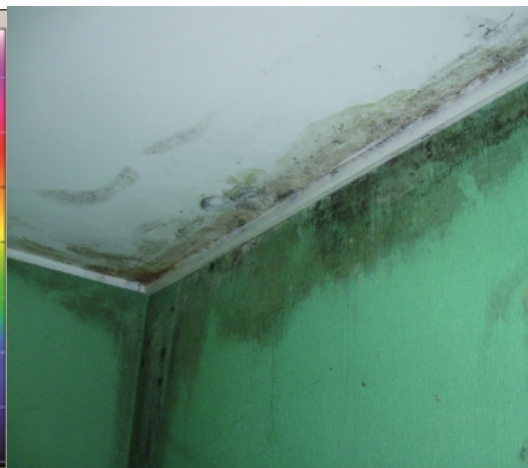
Fot. 2. Zjawisko obniżonej temperatury na wewnętrznej powierzchni przegrody – ryzyko rozwoju pleśni i grzybów pleśniowych
